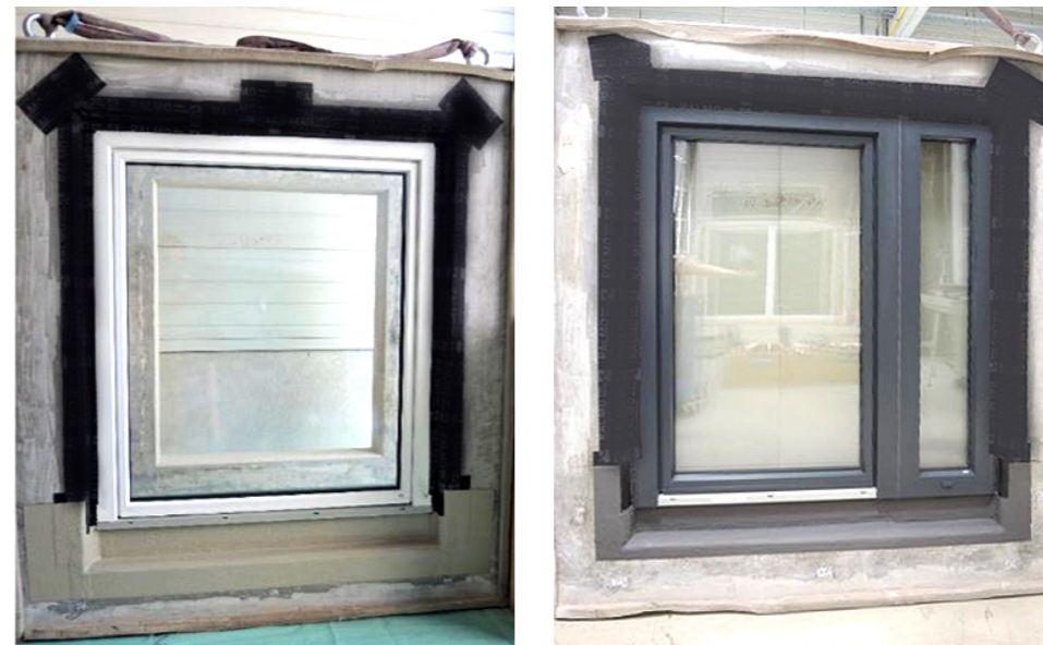
Abbildung 25) Links: Fensterelement – fertiggestellt für die Stauwasserprüfung. Rechts: Fensterelement mit Koppelung einer Fixver- glasung – fertiggestellt für die Stauwasserprüfung
